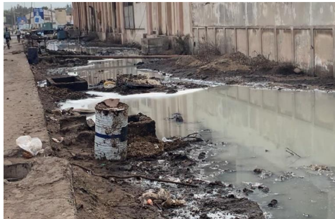
Photo 60 - Inondation constatée sur l'emprise du tracé le 09/06/22 (source: Sofreco, 2022)
