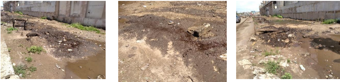
Figure 146 - Traces de polluants sur l'axe Kounoune – Cap des Biches (Sofreco / EGIS)
