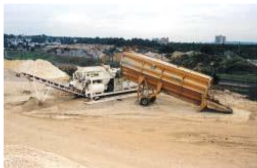
Photo 92 - Installation semi mobile SMS / MATRIF pour le traitement des déblais de chantier (source : Matériaux de construction)
